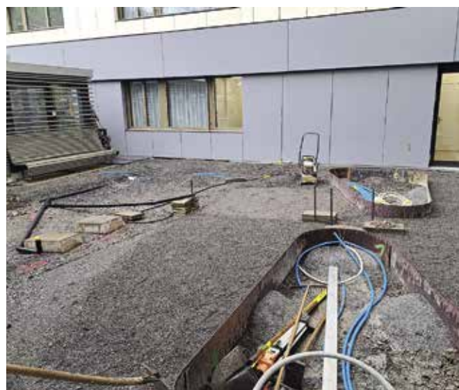
24. März 2023: Setzen der ersten Umrandungen für die neuen Gartenbeete, Einzug der Rohre für die spätere Bewässerung.
